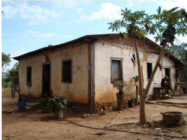
Foto 2 – Sede da Fazenda Curralinho . Proprietário Sr. Antônio Ventura. Nota-se claramente a introdução de novos materiais como o uso do tijolo de oito furos no fechamento da empena e o uso da telha de fibrocimento em substituição a telha de barro. O madeiramento antigo foi perdido pela ação de cupins e da umidade (apodrecimento).
